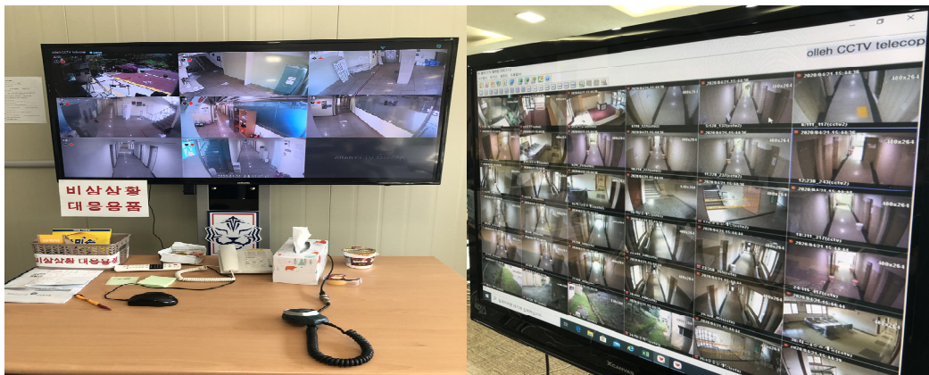
CCTV 예시 : CCTV와 마이크를 함께 두면 관리에 용이함
